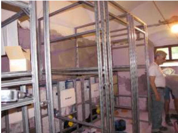
Die drei WC's und das Pissoir sind mit der Kanalisation und Wasserleitung verbunden und bereit für die Beplankung mit den GIS-Paneelen.
