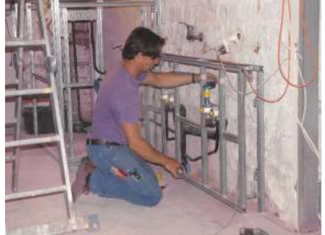
Alle UP-Wasserleitungen werden sauber gegen Schwitzwasser und Wärmeverlust isoliert.
