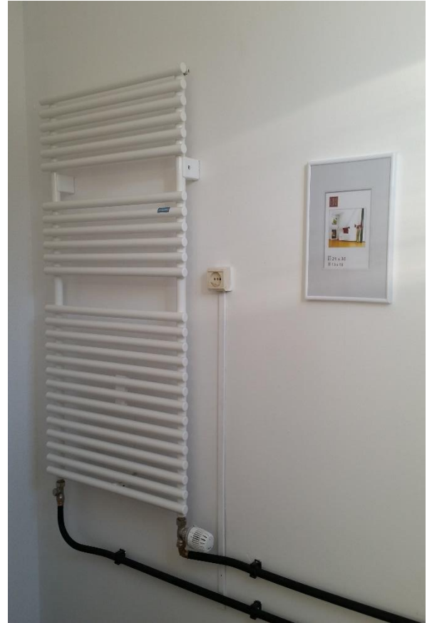
Überall neue Badtuchradiatoren.
