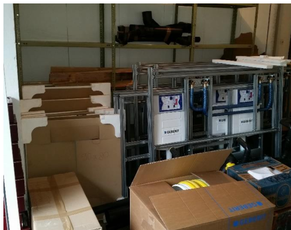
Duschen und vorgefertigte GIS-Rahmen.
