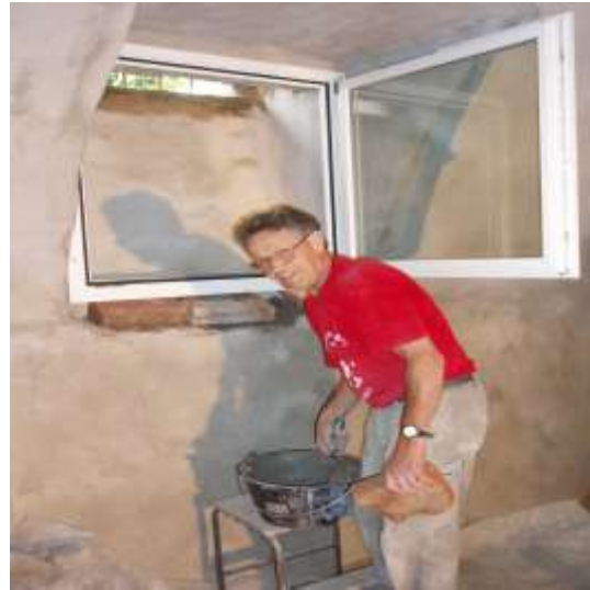
Die 4 „Luftlöcher“ werden vergrößert und mit Isolierglas-Kipp-Fenstern versehen.
