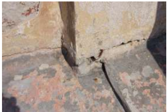
Unsachgemässe Wandanschlüsse und ihre Folgen
