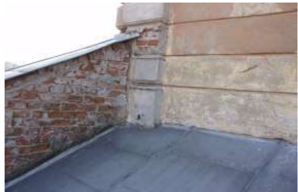
Überall abgesprungener Verputz mit Leckstellen
