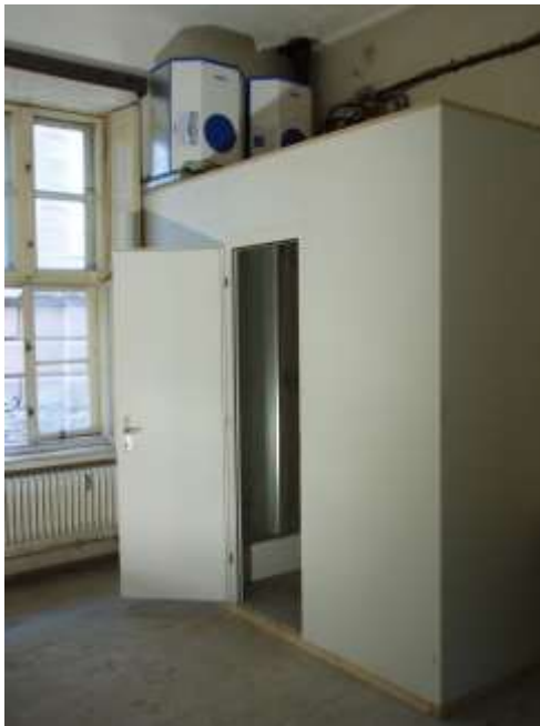
Einer von 2 Duscheräumen im Zimmer integriert, mit 120 l Boilern von Domotec
