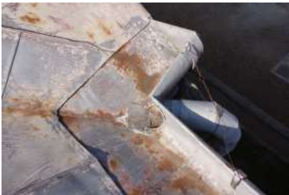
Zerrissene Nähte an Rinnen und -Stützen
