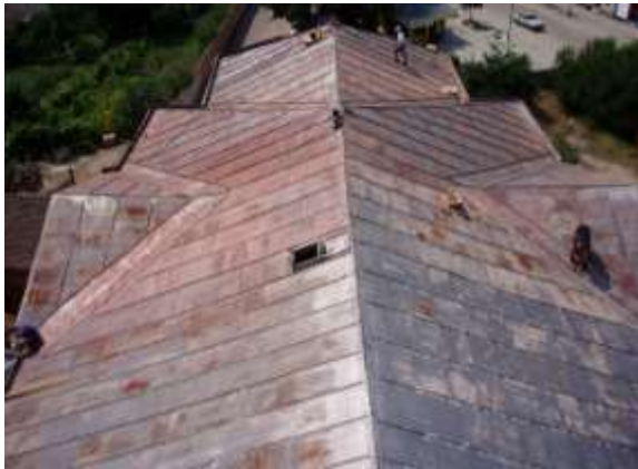
Das Kirchendach vor der Verjüngungskur
