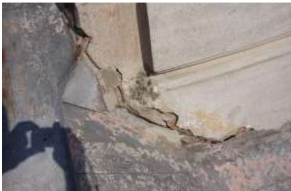
Schadhafte Stellen am Turm-Anschluss
